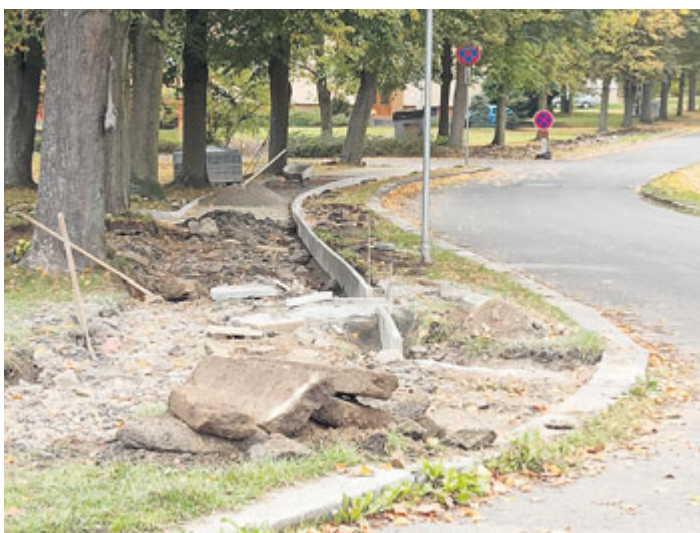
V ulici Československé armády na Starém sídlišti započala rekonstrukce chodníku. Prosíme o zvýšenou opatrnost chodců v tomto místě.
